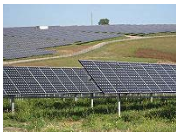
Slika 2: Solarna elektrana Serpa u Portugalu snage 11 MW
